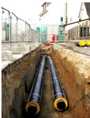
Réseau enterré d'eau chaude
